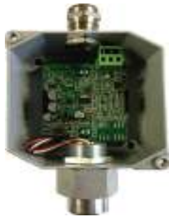
Sonda con Sensore da Sostituire
